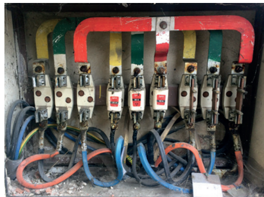
Wnętrze złącza kablowego niskiego napięcia
