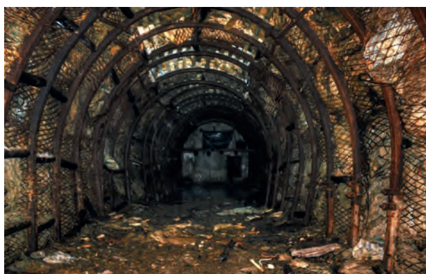
Rys. 3. ESP Młoty – sztolnia w obudowie tymczasowej Źródło: opuszczone.net
