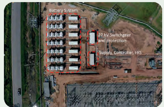
Rys. 22. Baterijny magazyn energii współpracujący z rozdzielnią 22 kV
