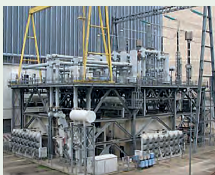
Rys. 15. Rozdzielnica gazowa w ciągu wyprowadzenia mocy z bloku elektrowni jądrowej
