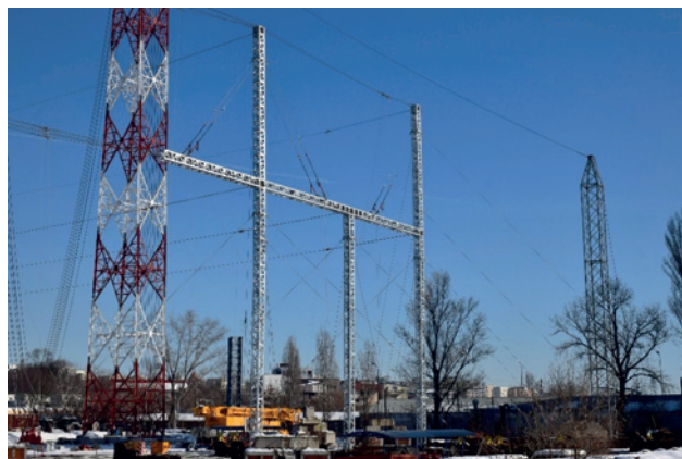
Portalowy słup odporowo-narożny 150° 400 kV UMKW z płaskim układem przewodów na stanowisku badawczym
